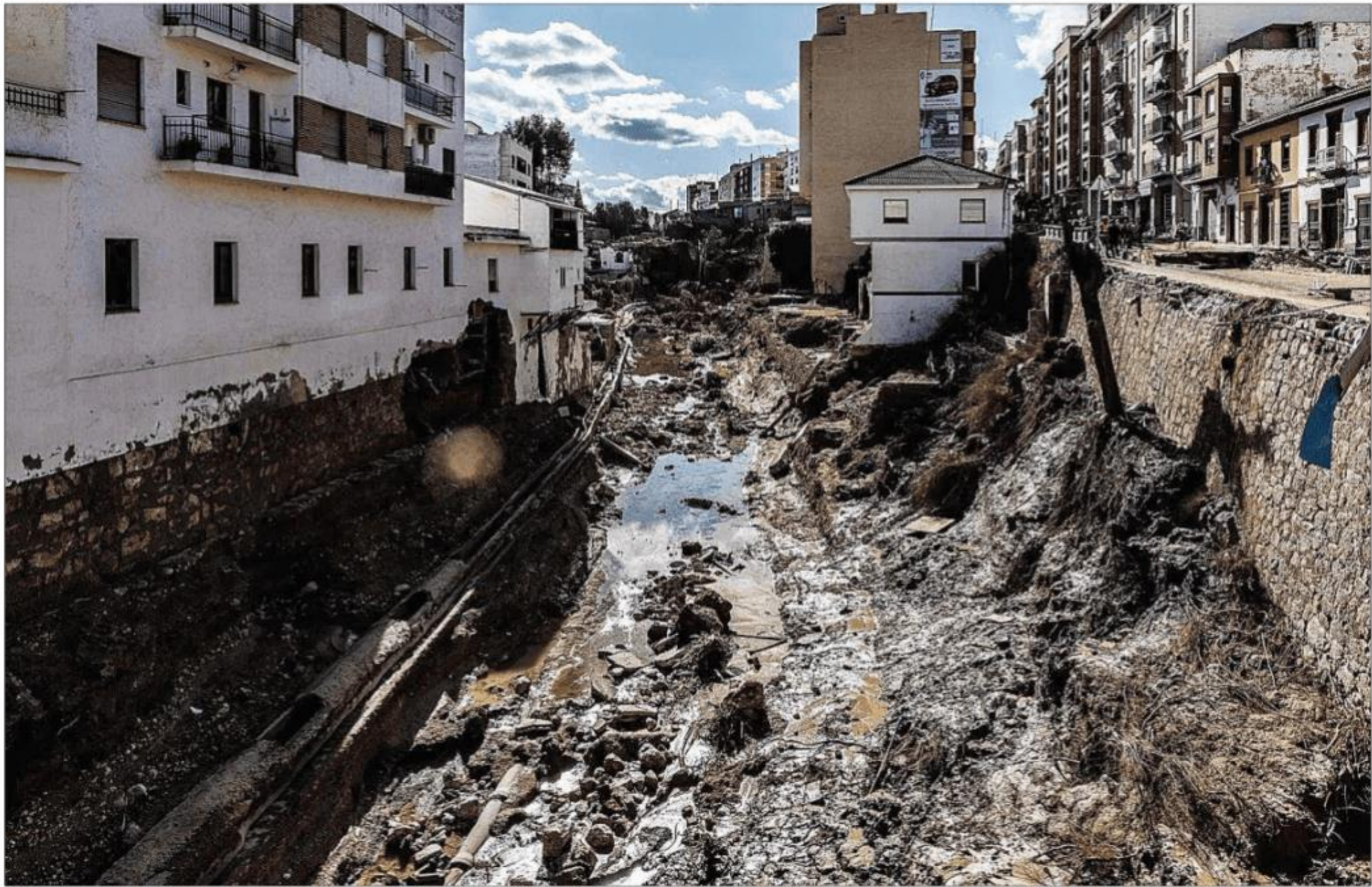
El barranco de Chiva, en el centro de la localidad, arrasado por el paso de la DANA. CARLOS GARCÍA POZO
